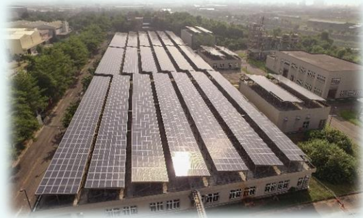
高雄市本洲工業區淨水廠1.4MW
