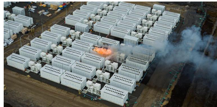
2021年特斯拉澳洲Megapack電池儲能基地起火， 燒了4天仍未熄滅
