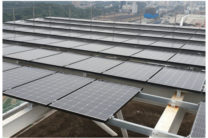
東明社會住宅太陽光電設施
