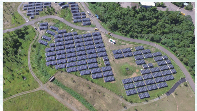
南港山水綠生態公園 太陽光電系統
